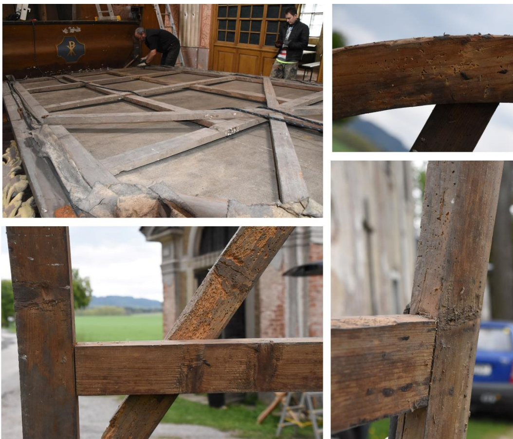
Stav původního rámu
